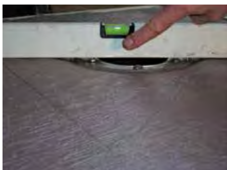
10. Kompletna hidroizolacijska garnitura je ispod nivoa košuljice što omogućava nesmetano postavljanje pločica.
